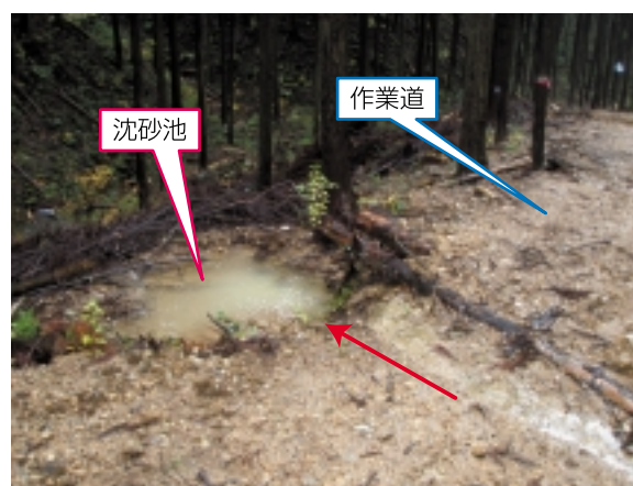
路面排水の下流に設置された沈砂池
