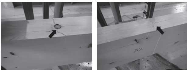
図-2. 試験体の破壊状況（上面圧縮側の圧縮破壊）
