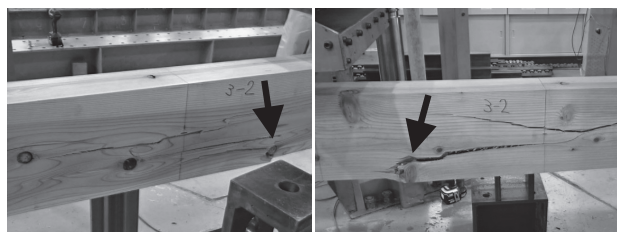
(木表側) (木裏側) 図-4 試験材の破壊状況（試験材 No3-2）
